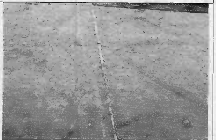
Fotografía N° 12: Irregularidades en los bordes de las juntas de la calzada
