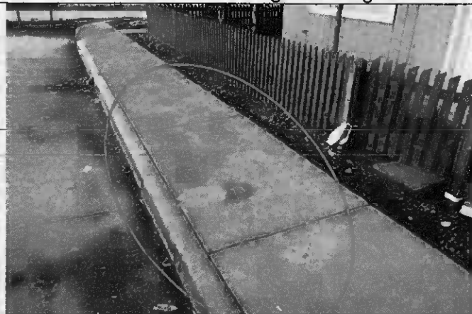
Fotografía N° 1: Huellas y deficiencias en la superficie de las aceras
