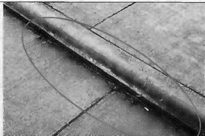
Fotografía N° 9: Irregularidades en la junta entre solera y calzada
