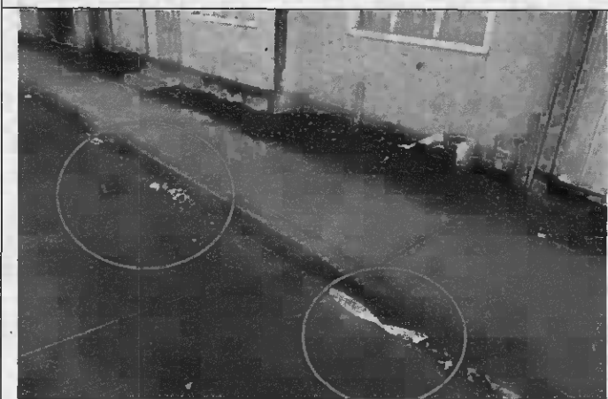
Fotografía N° 5: restos de materiales, basura y desechos en la vía pública
