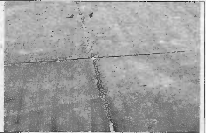
Fotografía N° 8: Irregularidades en los bordes de las juntas de la calzada
