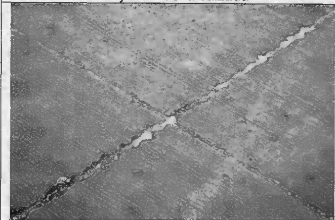
Fotografía N° 9: Irregularidades en los bordes de las juntas de la calzada
